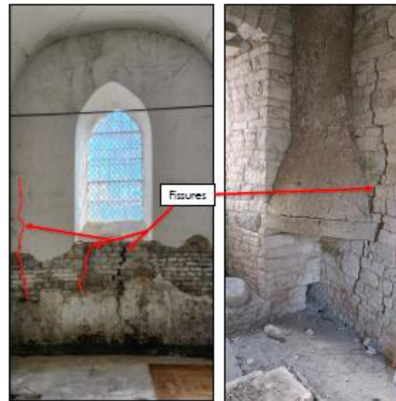
Photographie : Fissures verticales (aile de l'église à gauche)
